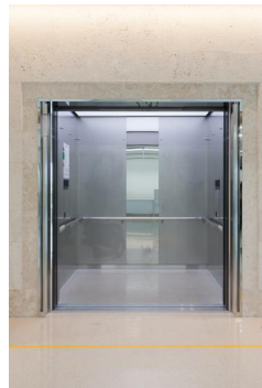
1.2号機エレベーター かご内 1
