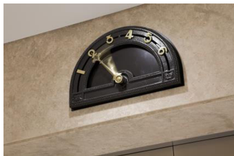
低層用エレベーター 乗場位置表示機
