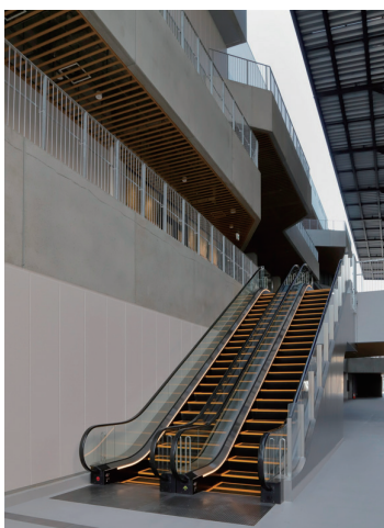
スタジアム エスカレーター9、10号機外観
