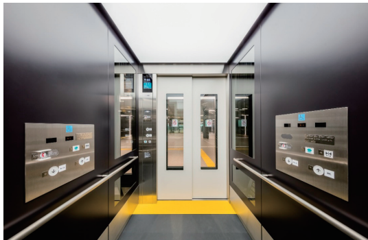
エレベーター1号機 かが内
