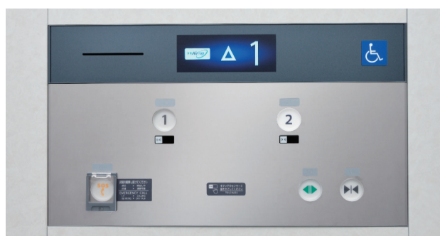
2号機 車いす操作盤
