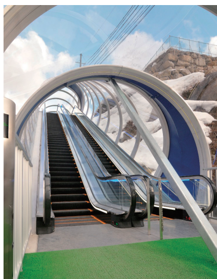
巨大アーチ内のエスカレータ 1-A・B号機
