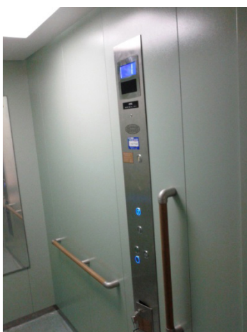
主操作盤と手摺
