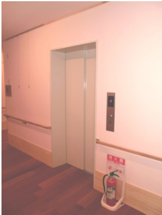
エレベーター全景
