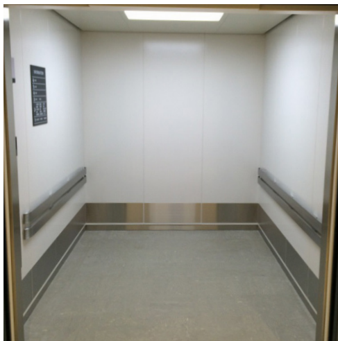
寝台用エレベーターかご内 1
