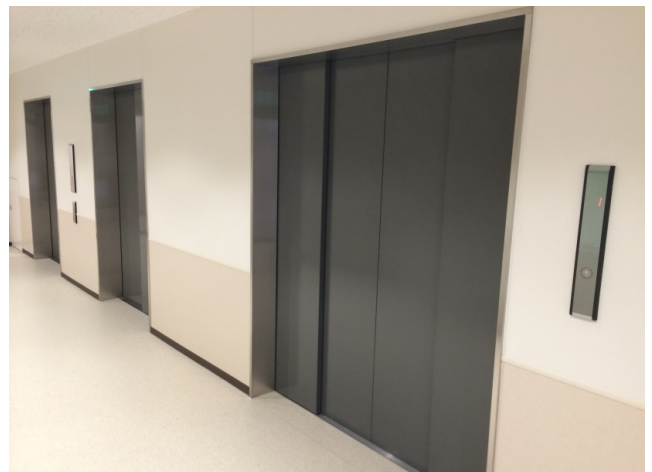
寝台用エレベーター乗場
