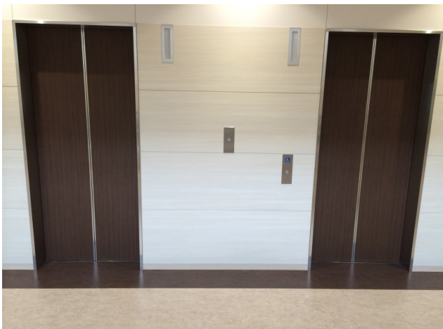
乗用エレベーター乗場
