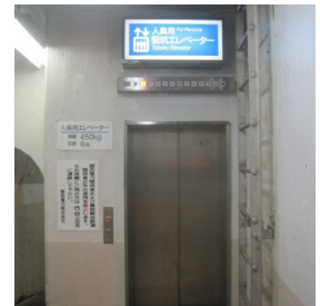
人員用エレベーター全景
