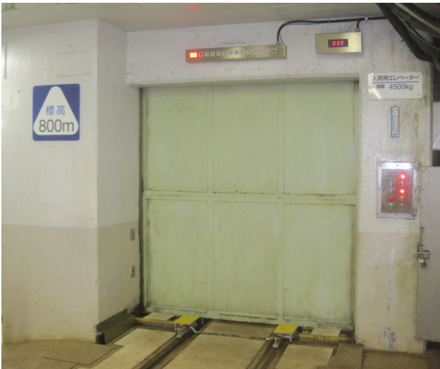
人荷用エレベーター全景 (標平上部乗場)
