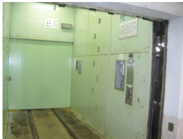
人荷用エレベーター内部
