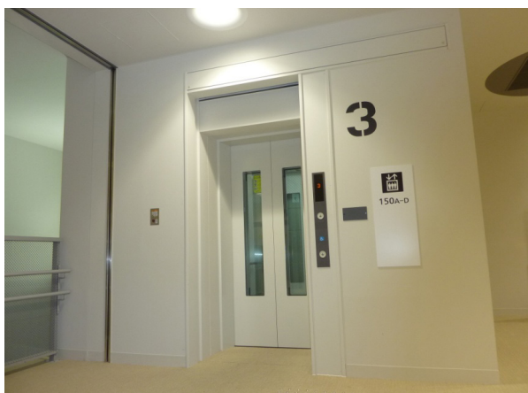
エレベーター No.5 : EV-T3-07H (3階)
