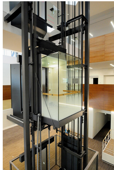
展望エレベーターのかご外観
