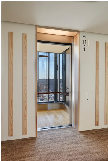
展望用エレベーター乗場
