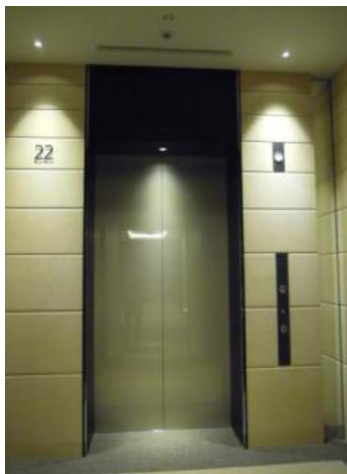
VIP用エレベーター乗場
