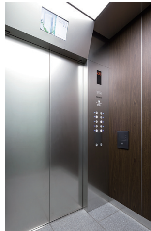
エレベーター室内
