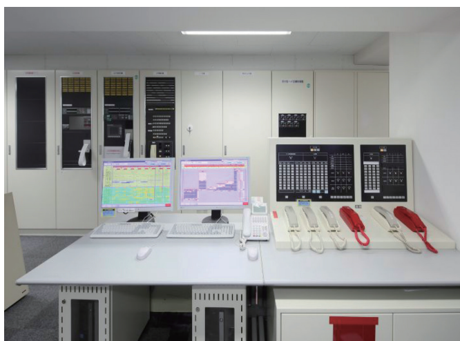
防災センター 昇降機監視盤
