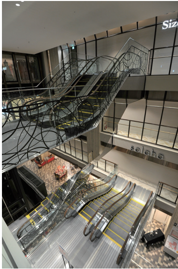
タワー館・ウイング館連絡用エスカレーター
