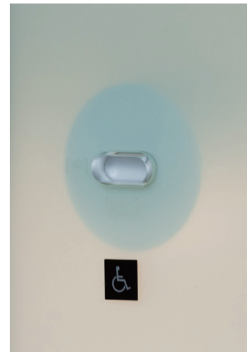
乗場押しボタン (建築ガラス壁に埋め込まれている)
